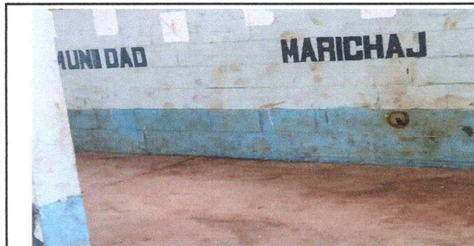
Foto 5: APLICACIÓN Y CAMBIO DE PINTURA EN PARED INTERIOR DE EORM COMUNIDAD MARICHAJ.
